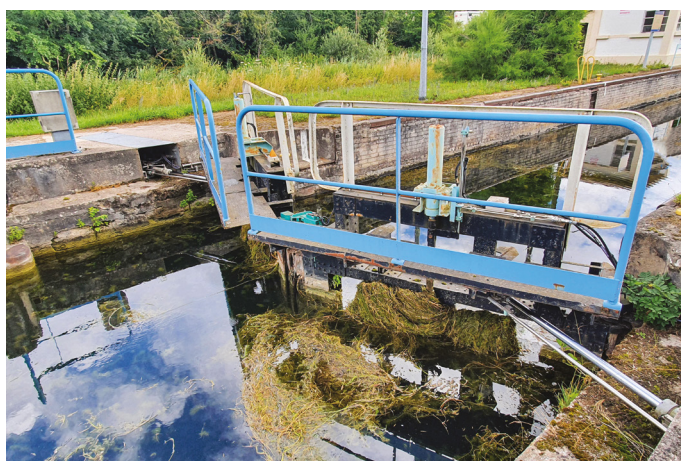
Figure 3-21 : Accumulation de végétaux aquatiques au niveau d'une écluse (VNF)
