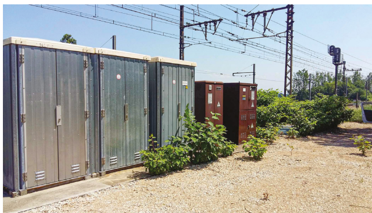
Figure 3-10 : Renouées asiatiques à proximité des installations électriques (SNCF Réseau)
