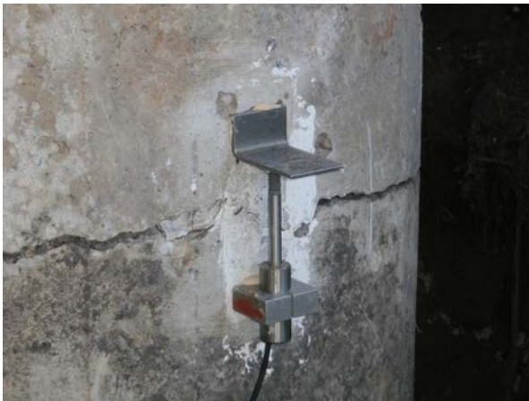
Figure 18a : L'instrumentation d'un ouvrage et son suivi permettent de valider les conditions de fonctionnement (ici suivi instrumenté d'une fissure).
