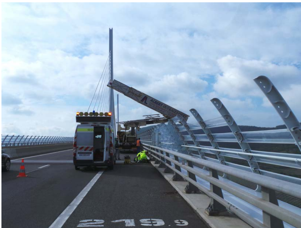
Figure 19 : Les moyens d'accès pour inspections ou sondages et leurs conséquences sur l'exploitation (Source Setec Diades)
