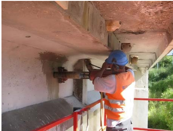
Figure 15a : Carottage : essai destructif dont il convient d'étudier avec soin la localisation
