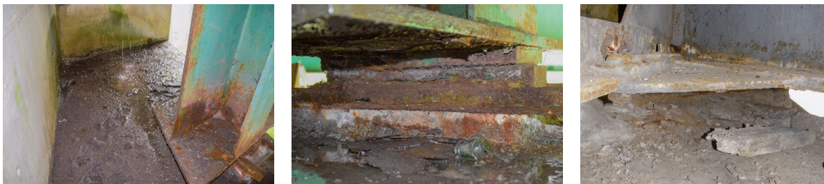
Figure 4-28 : Corrosion des abouts de poutres métalliques due au mauvais assainissement
