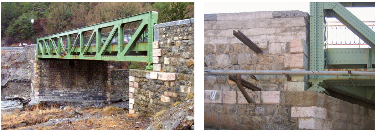
Figure 3-32 : Pont du Couleau sur la RN94 (05) : le très faible espace entre le montant d'extrémité de la poutre métallique et la culée rend très difficile sa remise en peinture
