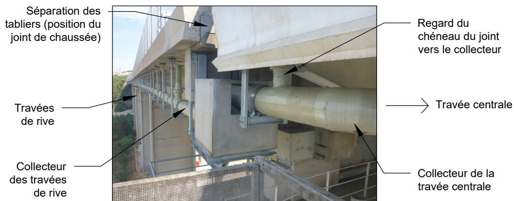
Figure 4-40 : Raccordement de l'assainissement entre la travée centrale et les travées de rive sur le viaduc de Caronte - Vue sur pile centrale (crédit : DIR Med)
