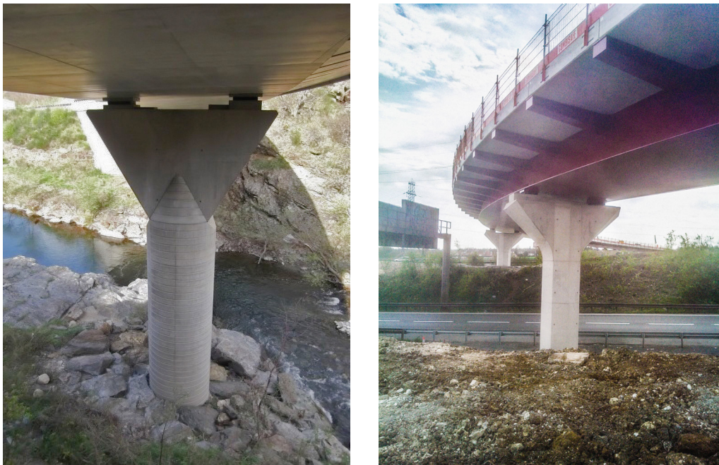
Figure 2-44 : Piles du pont de Saguenay sur la Mimente et de l'échangeur A2/A23 à La Sentinelle (59)
