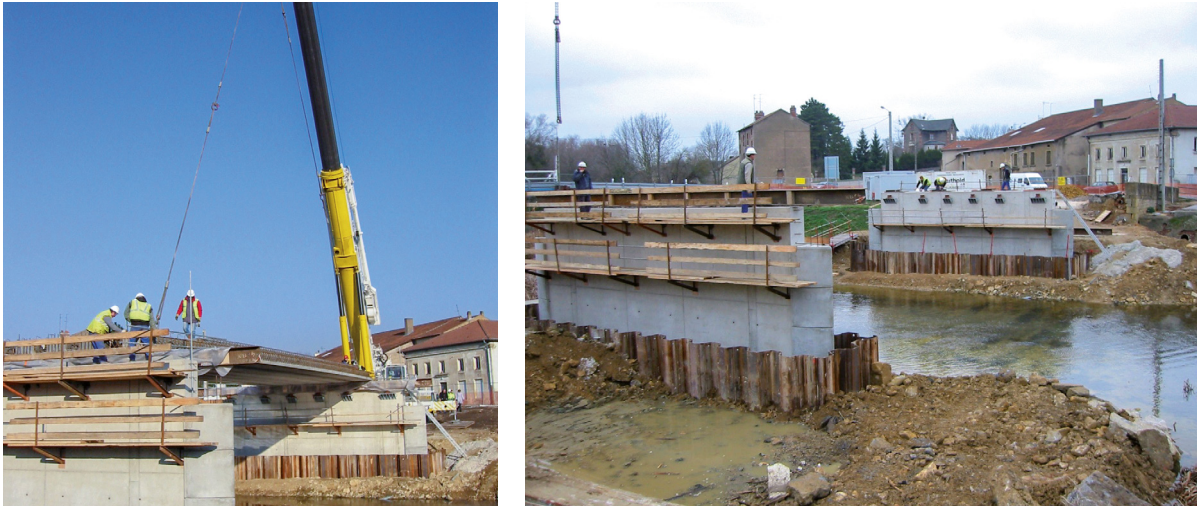
Figure 3-59 : Cintre supporté par des corbeaux sur le franchissement de l'Orne à Conflans (crédit : CD54)
