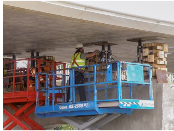
Figure 4-12 : Construction en sur-gabarit (ouvrage de Villeneuve-d'Ascq)
