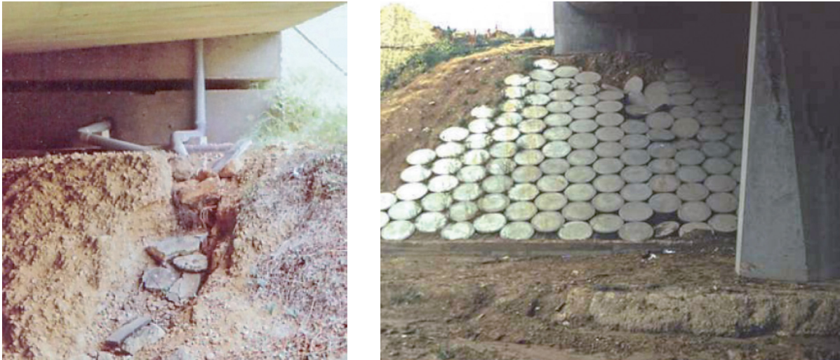
Figure 4-38 : Désordres sur perré dus au rejet direct des eaux sur celui-ci
