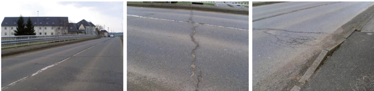
Figure 3-64 : Désordres constatés sur un ouvrage sans dalle de transition
