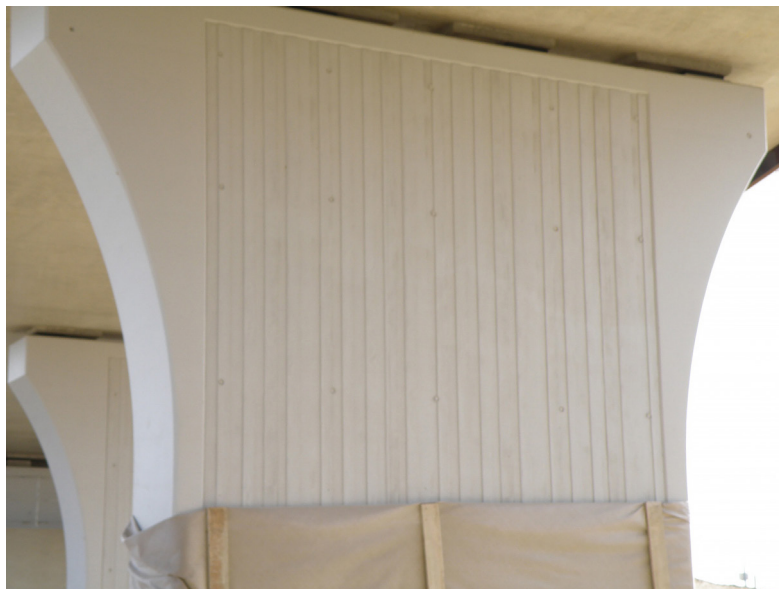
Figure 2-13 : Exemple d'évasement du voile en tête (type B) sur les piles d'un ouvrage sur la RN2 à Ormoy-le-Davien (60)
