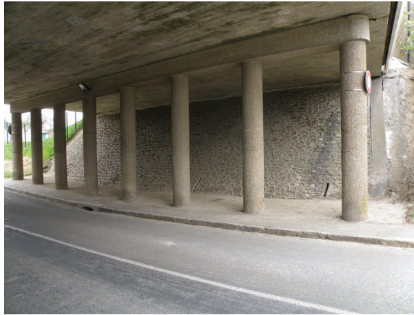
Figure 1-29 : Palée de poteaux sans raidisseur apparent ni dispositif de retenue – Configuration à proscrire
