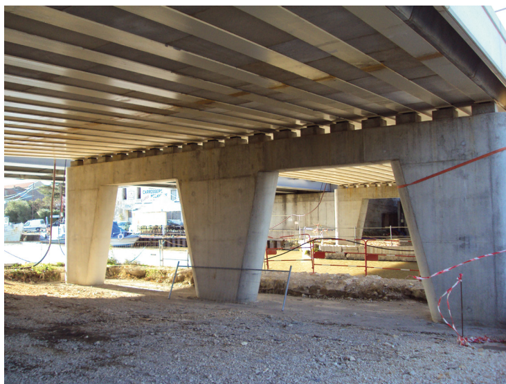
Figure 1-21 : Pile du pont de Saint-Gilles (34) : l'utilisation de trois voiles distincts nécessite la mise en œuvre d'un chevêtre pour appuyer les poutres du tablier à poutrelles enrobées
