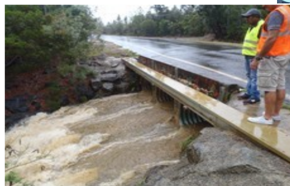
Illustration 7 : Expertise terrain DEPS / Cerema : identification des facteurs d'accident et des facteurs aggravants (Source : Cerema)
