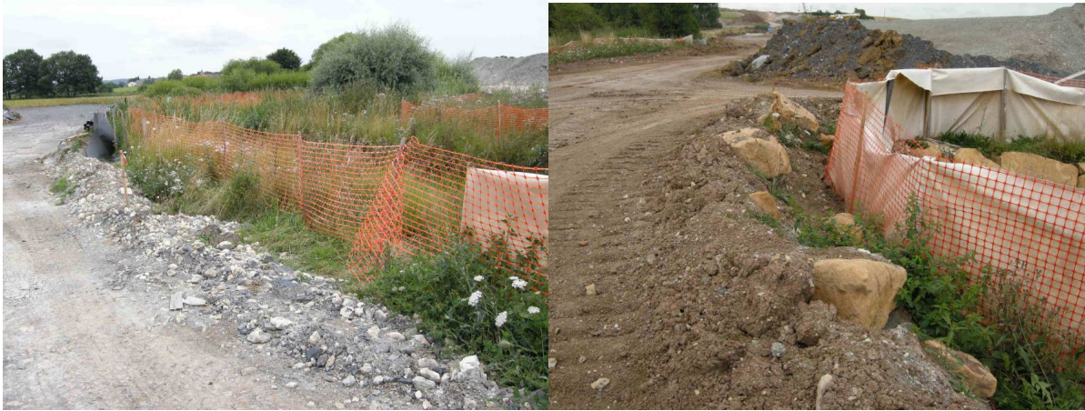
Illustration 8 - Merlons de protection des milieux aquatiques contre les eaux de ruissellement.
