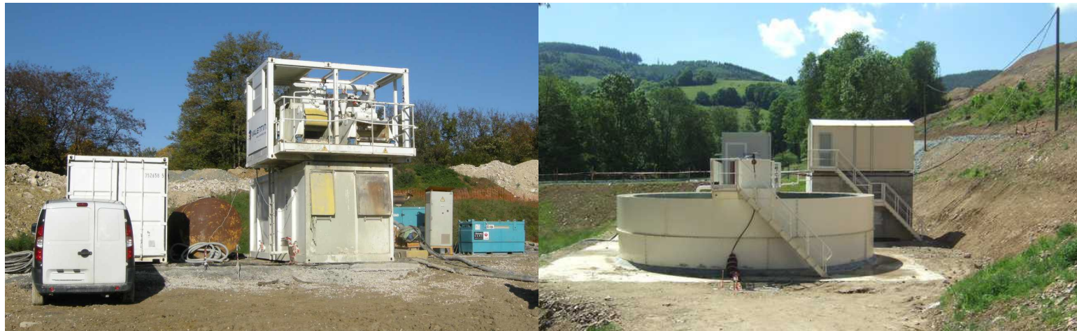
Illustrations 27 et 28 - Exemple de traitement proposé. Stations de traitement des eaux de chantier, pour éliminer les MES par système de floculation-décantation.
