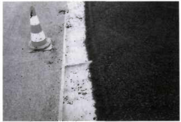
b) L'absence d'adhérence au support entraîne la formation de plis préjudiciables à la tenue de l'enrobé. En outre, lors de la mise en œuvre d'un enrobé chaud, on a observé des fusions de la chape.
