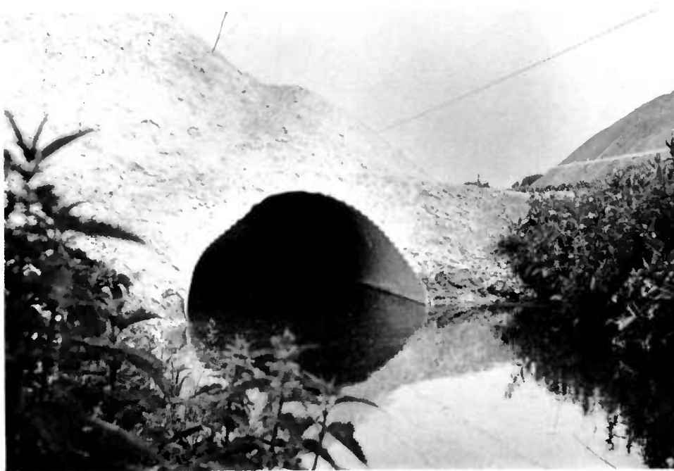
Figure 1.13 : Ecrasement latéral d'une buse dû à des poussées dissymétriques
