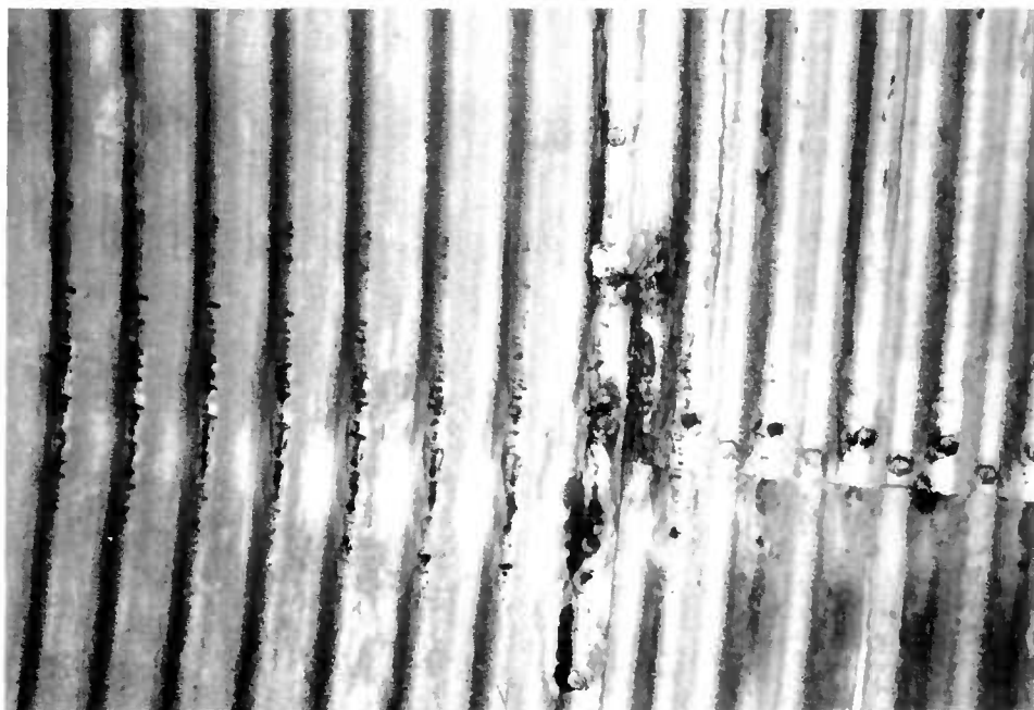
Figure 1.18. : Dégradation de la tôle et cisaillement des boulons par un véhicule circulant dans la buse
