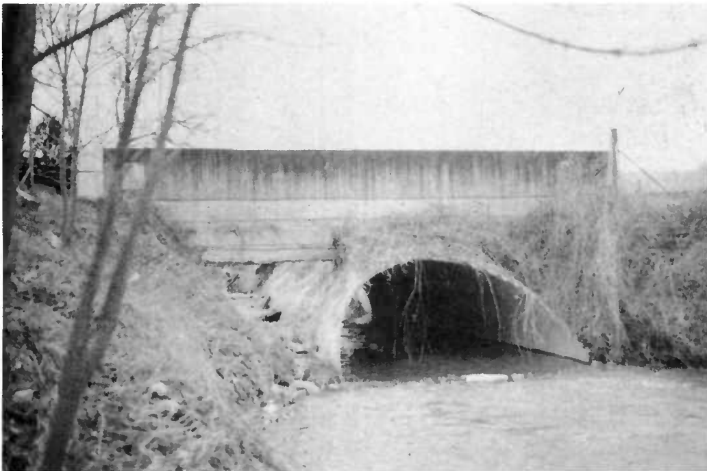
Figure 1.17. : Affouillement des remblais latéraux à la suite d'un soulèvement de l'extrémité au cours d'une crue
