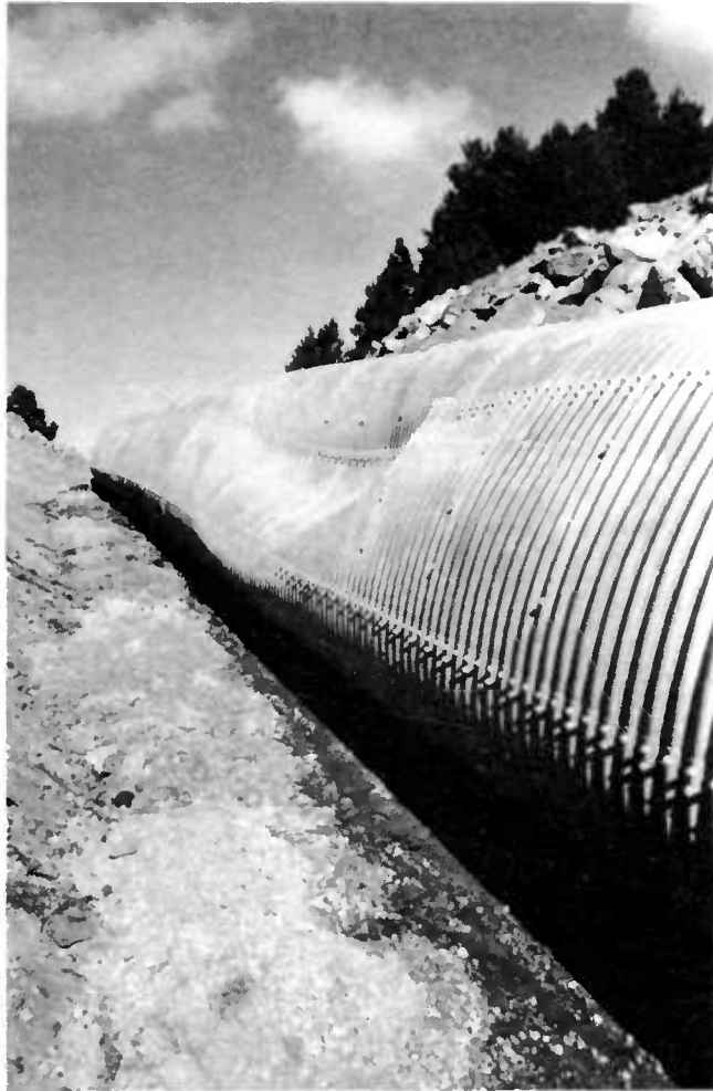
Figure 1.19. : Déformation de la tôle due à un engin de chantier (après déblaiement)
