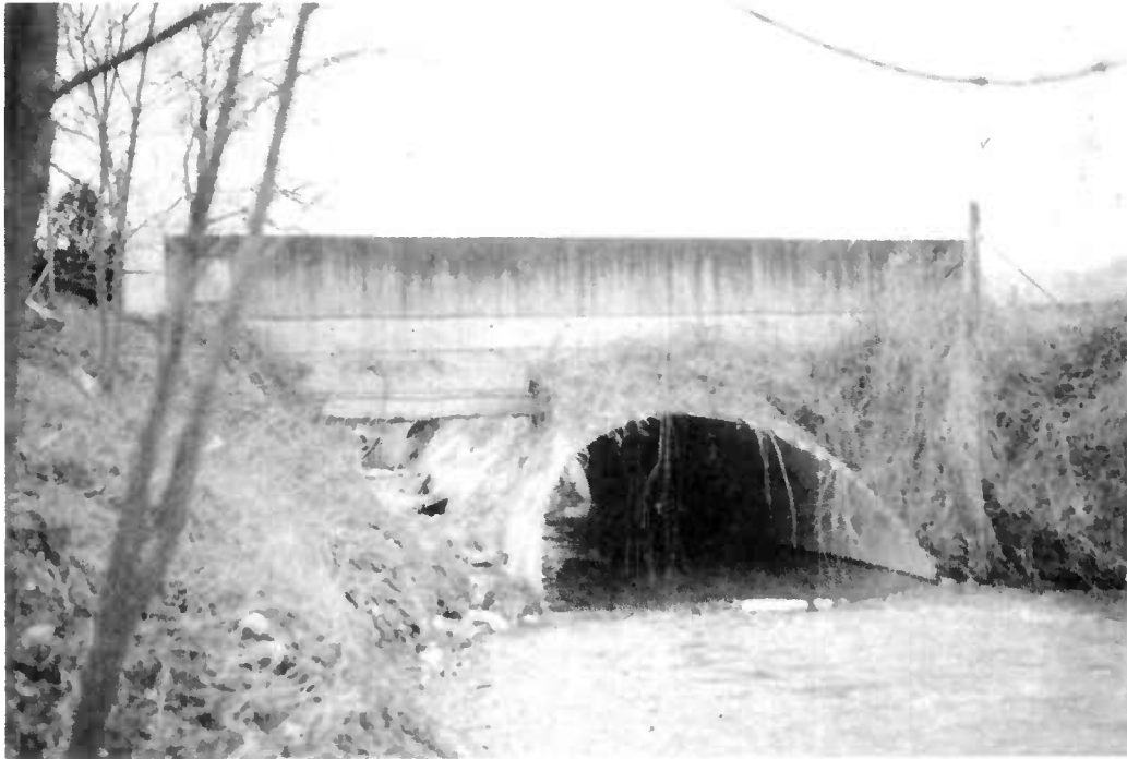
Figure 3.32. : Effondrement d'une partie de la chaussée
