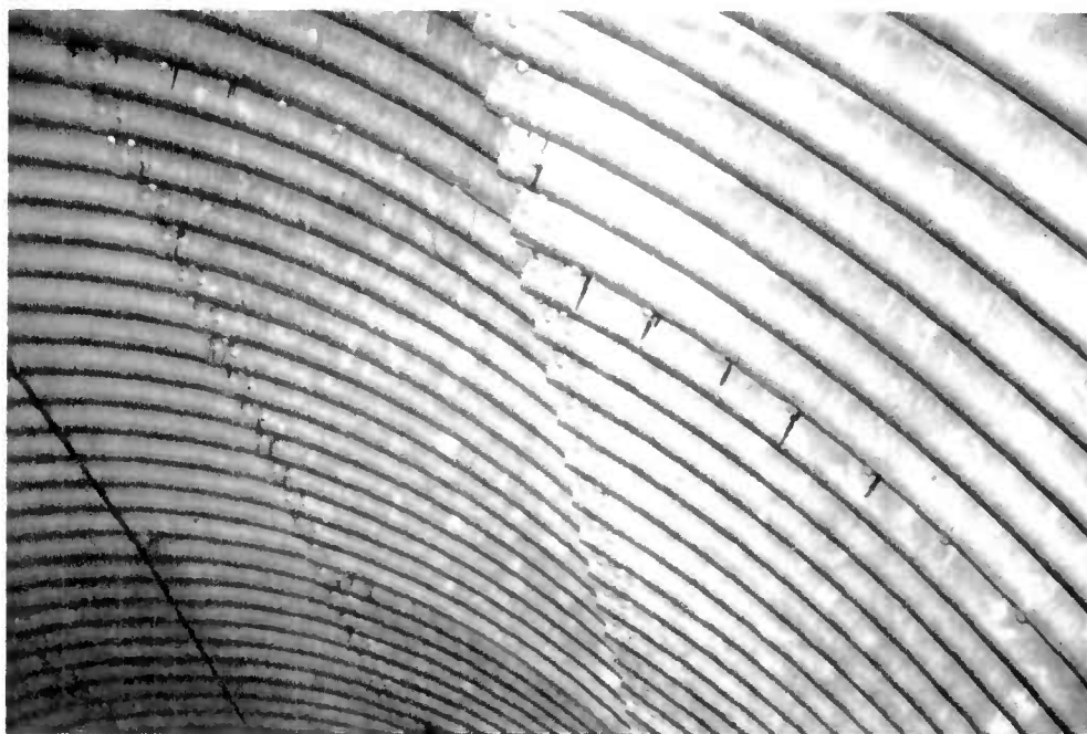
Figure 1.7. : Défaut de continuité de la forme d'une buse (légère rotation visible des plaques autour de leur joint longitudinal)
