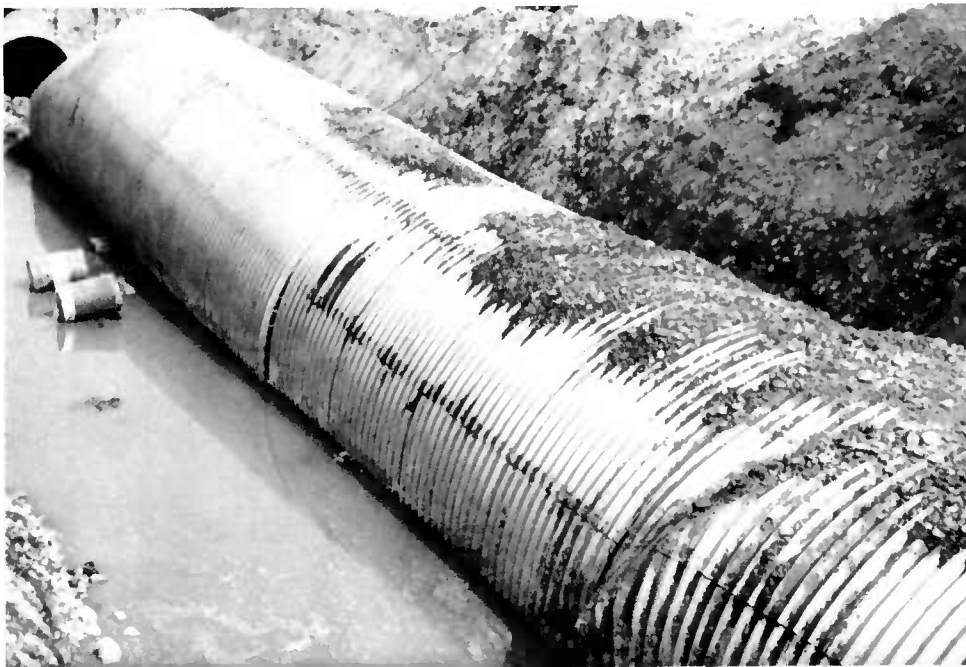
Figure 1.5. : Déchirure des joints circumférentiels par entraînement d'un remblai instable
