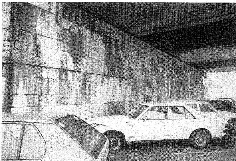
Fig. 17 — Écoulement d'eau à travers la maçonnerie d'une culée.
