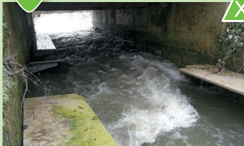
Le platelage en mélange bois/béton en plaque de 120 x 20 mm d'épaisseur est cassant et à proscrire. Source : GREGE.
