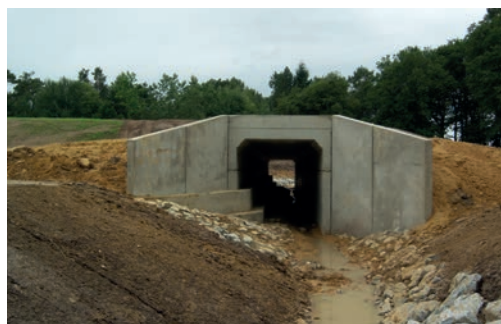
12 Sortie d'ouvrage aménagée pour assurer le maintien des berges. Source : P. Fournier GREGE.
