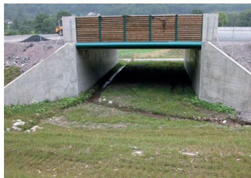
11 Passage inférieur permettant l'évacuation des eaux de ruissellement vers la pente. Source : Cerema.
