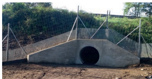
Clôture amphibiens contournant la tête d'ouvrage. Source : Cerema.
