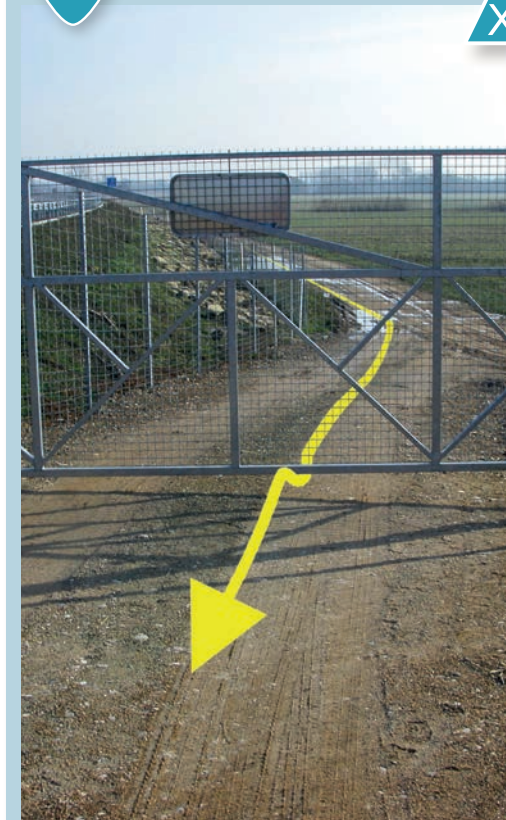
Espace disponible sous le portail permettant le passage de la petite faune. Source : Cerema.
