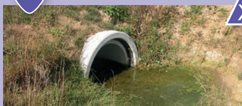
⑩ Les passages petite faune situés sous le terrain naturel et n'étant pas équipés d'une fosse de drainage sont souvent inondés et infranchissables. Source : Cerema.
