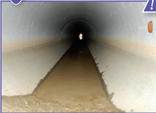
22 Accumulation de matériaux en sortie d'ouvrage empêchant le drainage de l'ouvrage. Source : Cerema.
