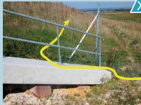
Raccord du grillage à l'ouvrage non adapté laissant à la faune le libre accès aux emprises. Source : Cerema.
