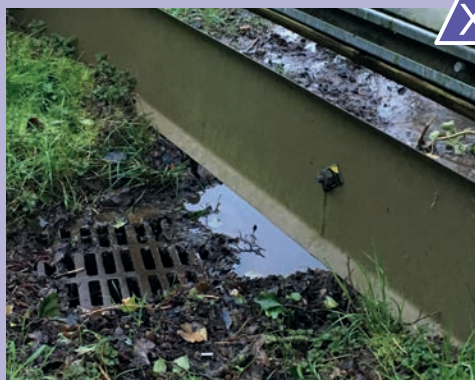
Dispositif de guidage conduisant à un avaloir. Source : Jérôme Bacquaert, CD62.
