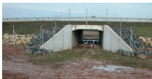
Clôture grande faune contournant la tête d'ouvrage. Source : Cerema.
