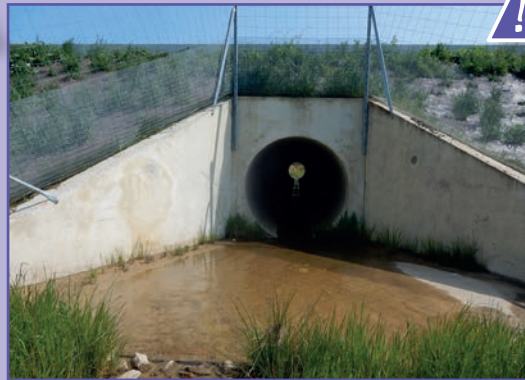
23 Ouvrage inondé limitant le passage de certains animaux au moins une partie de l'année. Source : Cerema.
