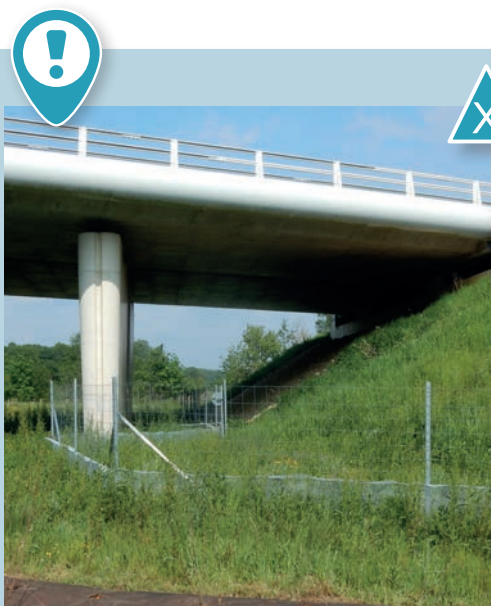
Mauvais raccordement de la clôture qui passe sous l'ouvrage et diminue l'espace disponible pour la faune. Source : Cerema.
