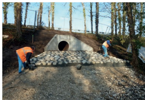
19 Réalisation d'une rampe maçonnée avant recouvrement avec de la terre. Source : Vinci Autoroutes/Réseau ASF.
