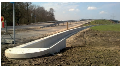
12 Dispositif de guidage en retour aux extrémités du collecteur. Source : Maibach.
