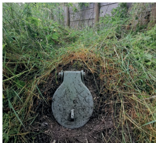
13 Clapet antiretour sur descente d'eau empêchant la faune d'accéder aux emprises. Source : P. Fournier, GREGE.
