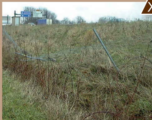
Clôture dégradée lors d'un accident de la circulation. Source : Cerema.
