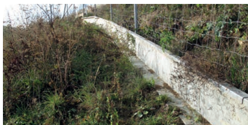
3 Bordure métallique surmontée d'une clôture faune. RD16 (CD57). Source : Cerema.
