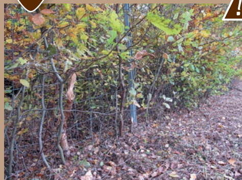
L'absence d'entretien de la clôture côté extérieur de l'emprise ne permet pas de la maintenir en bon état. Source : Cerema.
