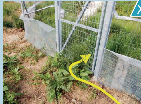
Clôture mailles fines discontinue permettant l'accès aux emprises pour les amphibiens au droit du portail. Source : Cerema.
