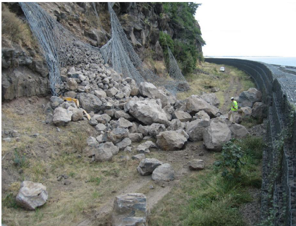
Figure 33 : Ouvrage sollicité au-delà de ses capacités (Source : NGE)
