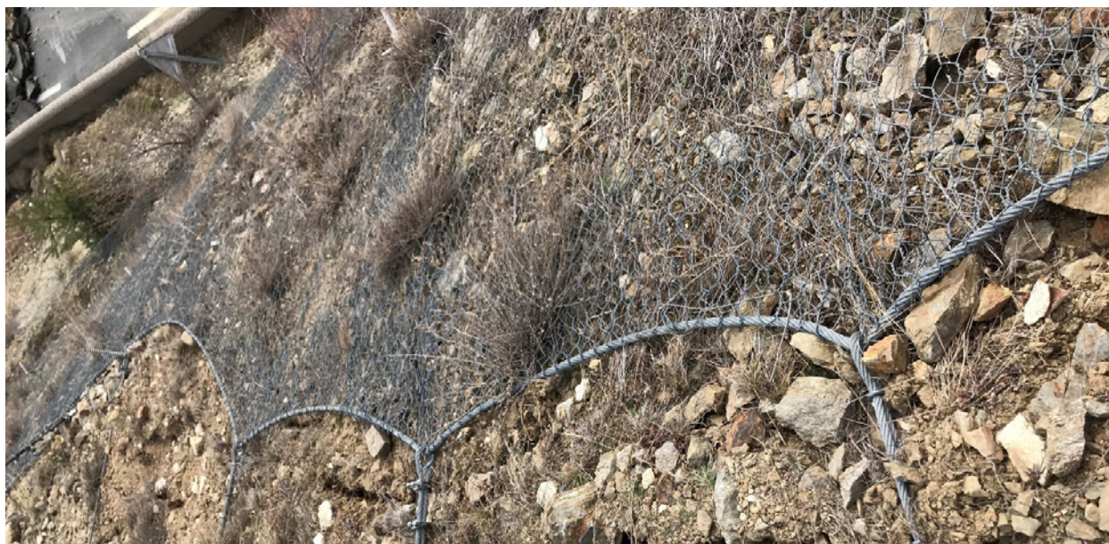
Figure 10 : Une rive supérieure sous tension : pas de résistance possible sans flèche (Source : NGE)
