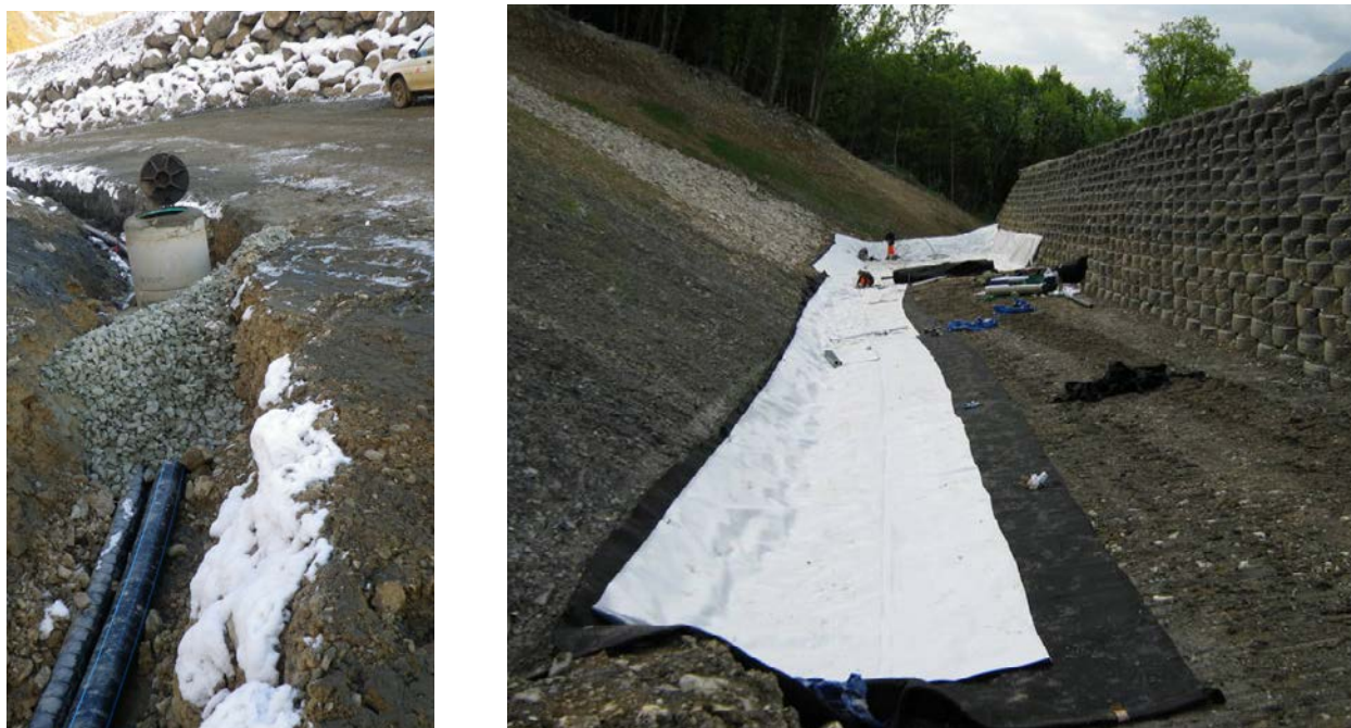
Figure 14 : Tranchée drainante en pied du talus de raccordement (gauche) et géosynthétique drainant en fond de fosse, côté talus de raccordement (droite). Communes de Freney d'Oisans (38) et Veyrier-du-Lac (74) (Sources : ONF-RTM)
