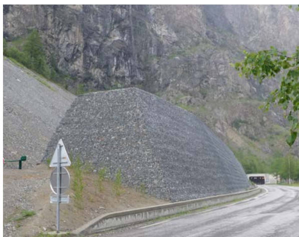
Figure 4 : Merlon à parement minéral (Source : S. Lambert, INRAE)
