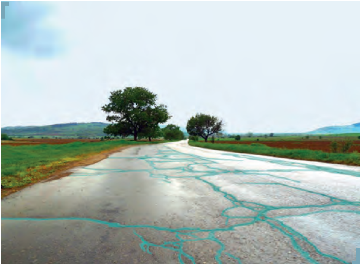
Illustration 9 : Détection automatique de fissures par IA. (Source : Vaisala)
