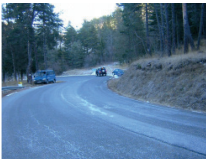
Photo 1 : Phénomène de glissance observé, notamment dans les bandes de roulement (Source : CD 04)
