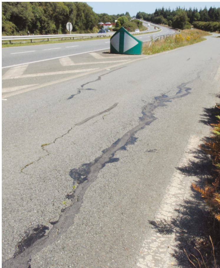
Figure 46 : Fissures d'amorce de glissement : le pontage des fissures réduit l'aggravation du phénomène (Source : Cerema Ouest)
