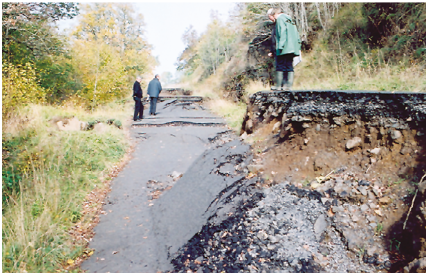
Figure 12 : Rupture d'un remblai sur pente instable (Source : MEDDE)
