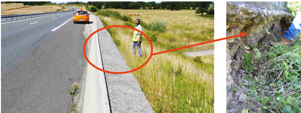
Figure 6 : Exemple d'érosion régressive du bord de talus, sous la glissière en béton armé (Source : Cerema Normandie-Centre)
