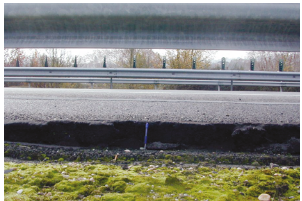
Figure 28 : Affaissement d'un accotement consécutif à la sécheresse de 2003 (Source : Cerema Sud-Ouest)
