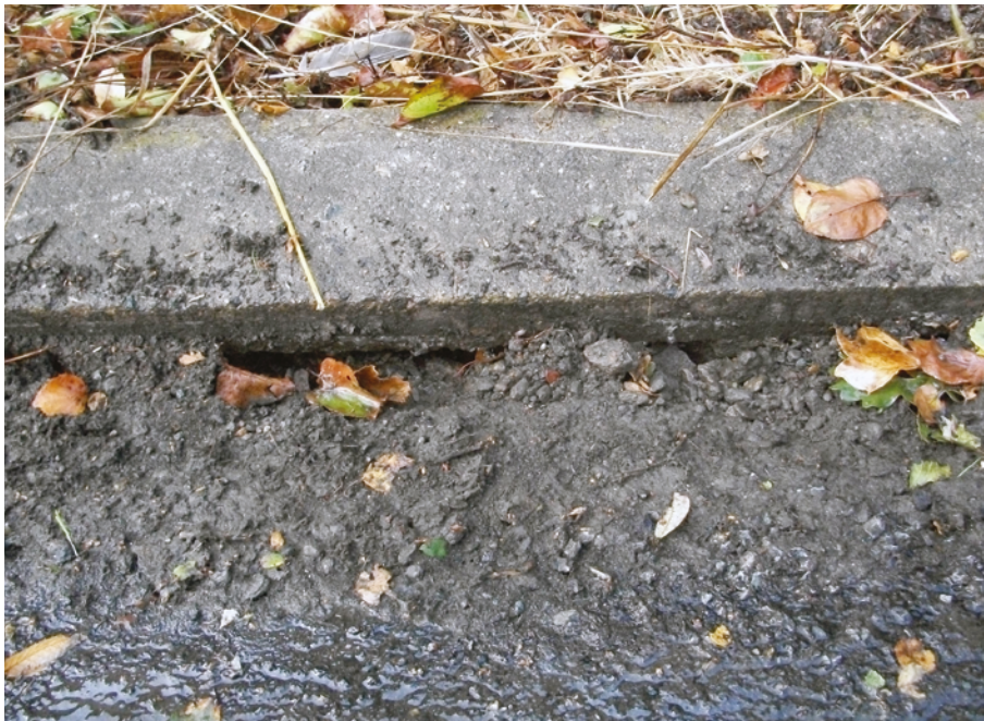
Figure 45 : Défaut d'étanchéité entre la bordure béton et la couche de roulement (Source : Cerema Ouest)
