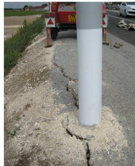
Figure 26 : La fissure longitudinale qui se manifeste au niveau des glissières ou en bord de remblai est due à des phénomènes de tassements différentiels caractéristiques d'un sous-compactage de bord de remblai (désordre P2). Ces phénomènes peuvent se manifester rapidement après la réalisation de l'ouvrage, lorsque le talus excédentaire n'a pas été réalisé ou éliminé, ou le plus souvent lors d'un élargissement de remblai. (Source : Université Gustave Eiffel)
