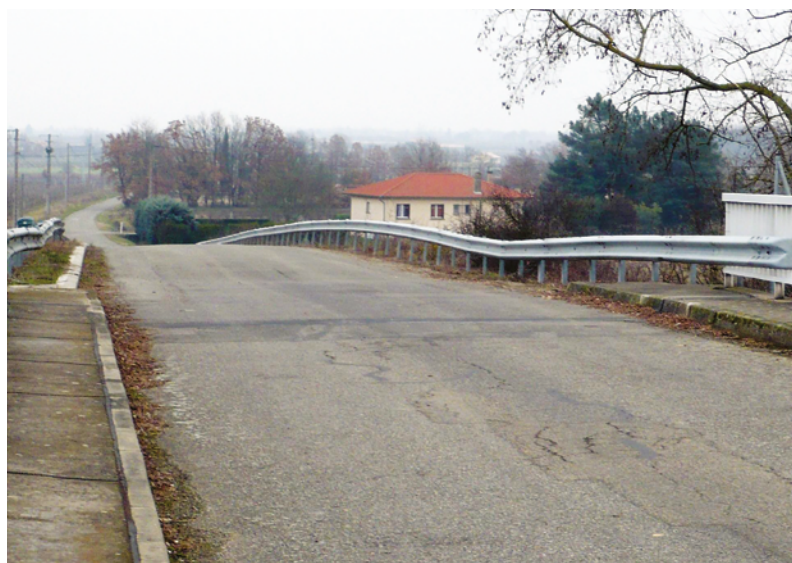
Figure 29 : Tassement différentiel du remblai contigu à un ouvrage, bien visible sur les glissières de sécurité (Source : Cerema Sud-Ouest)
