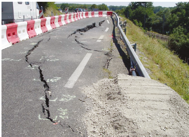
Figure 25 : Fissures circulaires avec rejet témoignant d'une rupture du talus de remblai (Source : Cerema Sud-Ouest)
