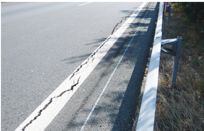
Figure 13 : Fissuration par retrait en lien avec le réseau racinaire des arbres (Source : Cerema Sud-Ouest)
