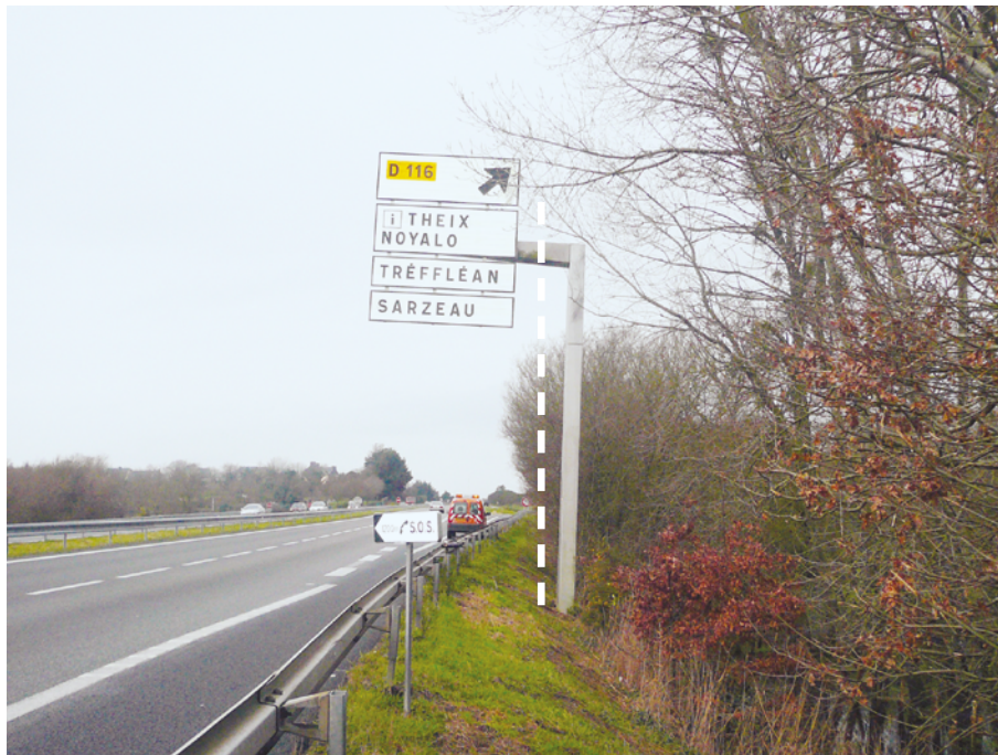
Figure 14 : Potence inclinée : l'inclinaison de la potence peut révéler une pathologie du remblai (Source : Cerema Ouest)
