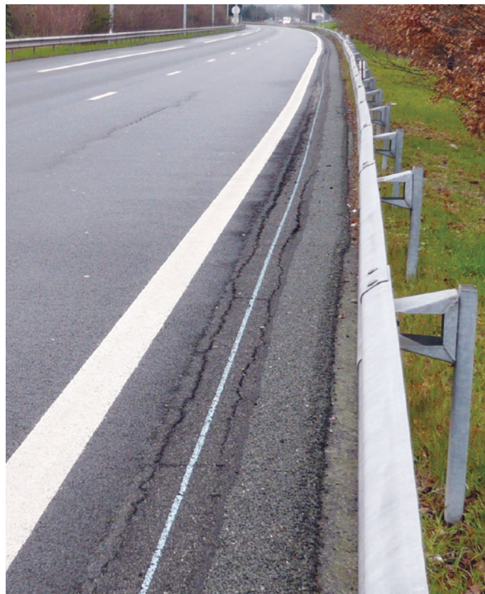
Figure 17 : Fissures correspondant à une tranchée de « fibre optique » (Source : Cerema Sud-Ouest)
