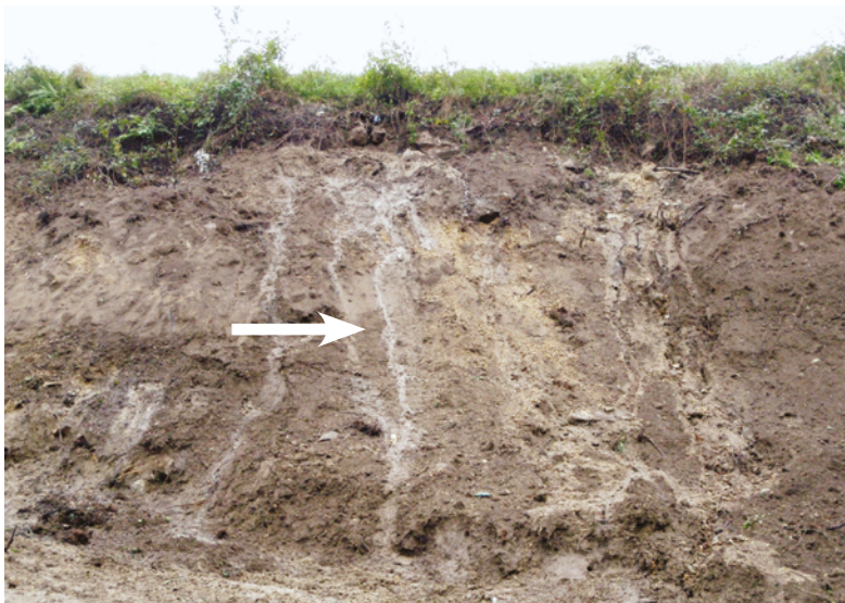
Figure 7 : Point de sortie d'eau piégée dans un remblai et se manifestant au moment de travaux de reprise de talus (Source : Cerema Ouest)
