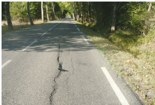
Figure 27 : Affaissement et fissure avec rejet consécutifs à la sécheresse de 2003 (Source : Cerema Sud-Ouest)
