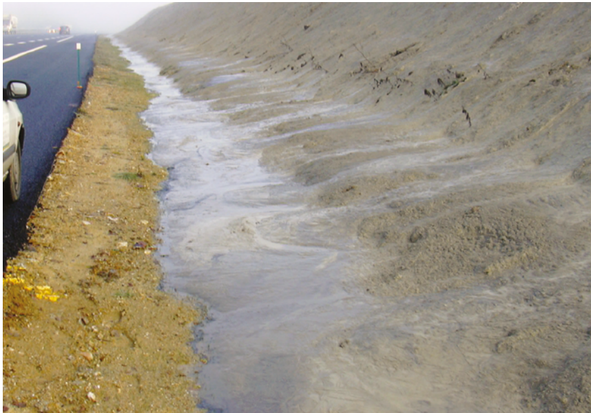
Figure 21 : Liquéfaction de surface sur un merlon (Source : Cerema Ouest)
