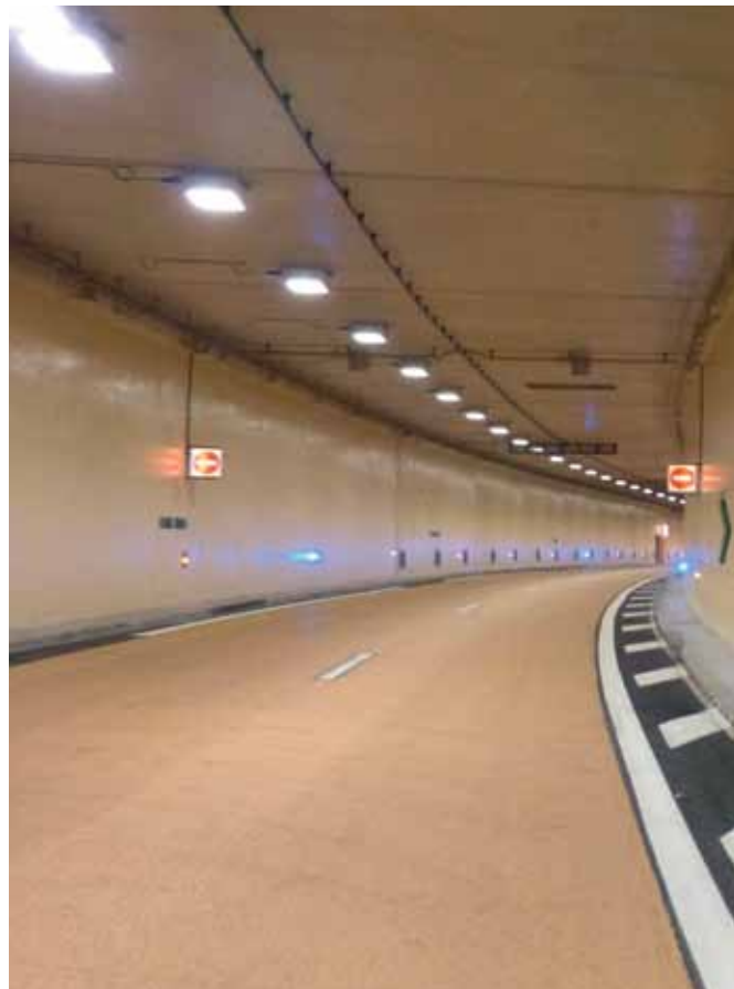
Câble rayonnant en axe de chaussée (tunnel de Toulon/tube sud)
