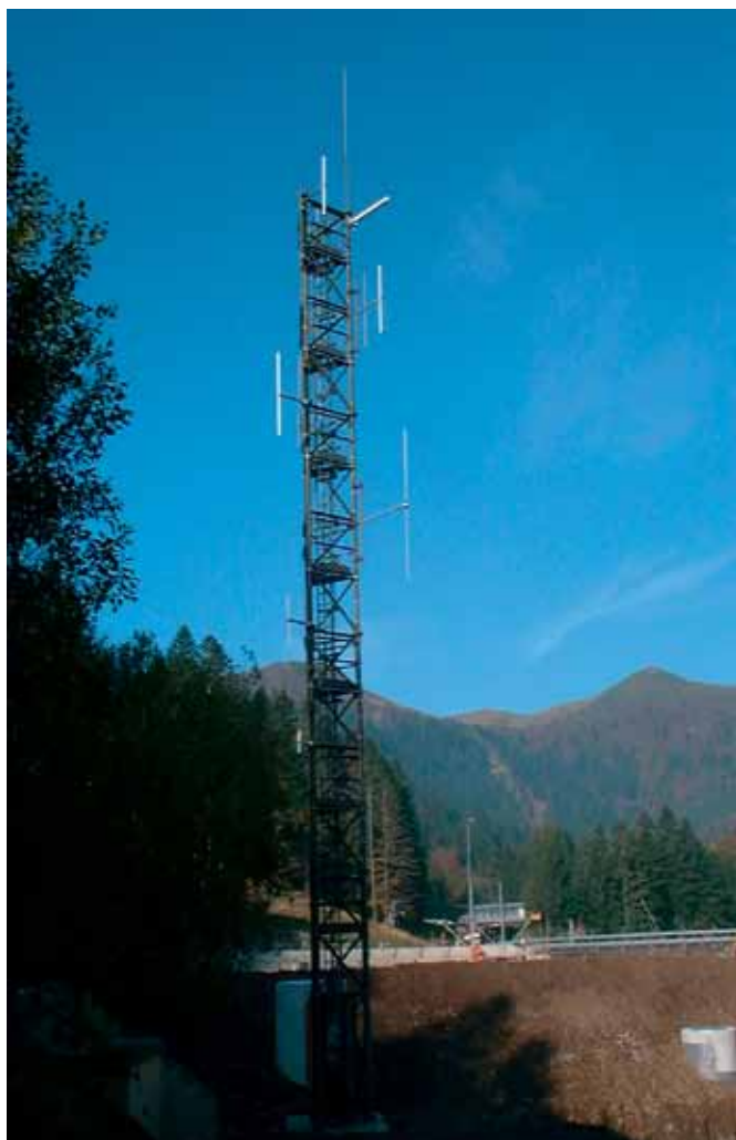
Pylône et antennes (tunnel du Lioran)
