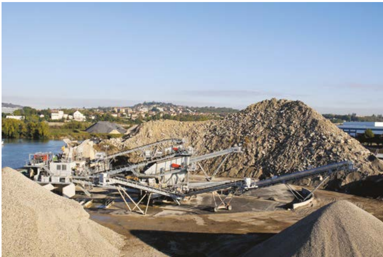
Illustration 2 : Installation fixe de concassage criblage (Source : VINCI).
