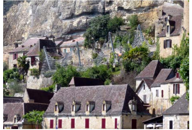
Figure 7. Exemple de contrainte d'emprise : écran en cours de montage en zone urbaine (La Roque-Gageac, Dordogne, juillet 2010. Source :Cerema).
