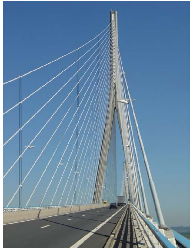
Figure 20 : aiguilles antivibratoires du pont de Normandie
