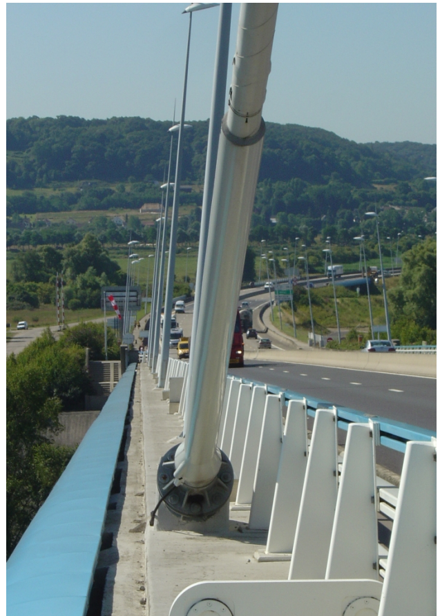
Figure 18 : tube de transition et antivandalisme
