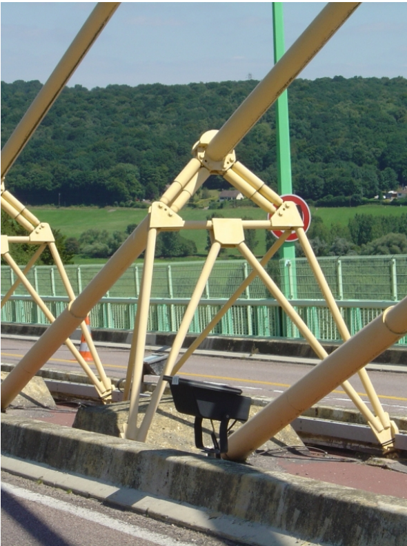
Figure 19 : amortisseurs du pont de Brotonne
