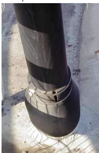
C – Fissuration de la jonction entre le tube coffrant et le tube anti-vandalisme
