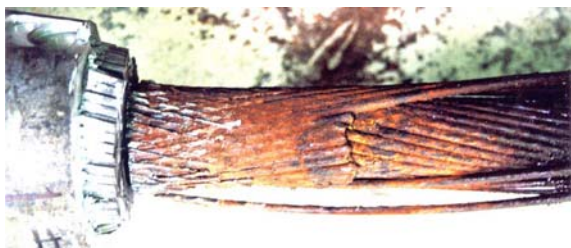
A - Ruptures de fatigue toron multicouche
