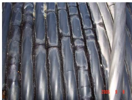
B - Rupture différée d'une gaine de toron
