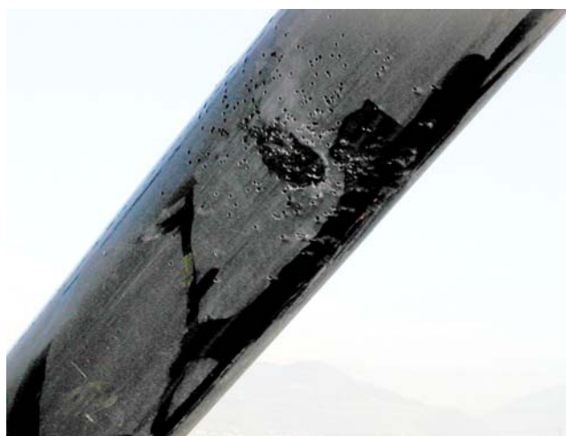
D – Dégradation de la gaine PEHD par vandalisme
