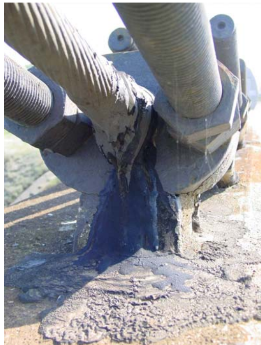
B – Détérioration du complexe anti-corrosion au droit d'un ancrage
