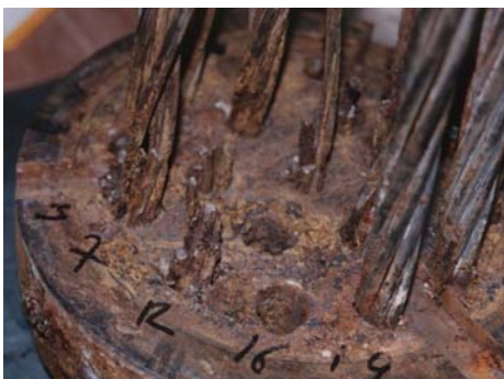
C - Ruptures amorcées sur des cratères de corrosion
