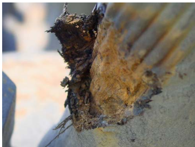
A – Mauvaise application du complexe anti-corrosion
