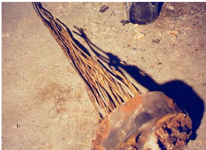
Rupture d'un c ble par corrosion
