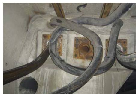
Déformation de câbles 19T15 lors d'un démontage
