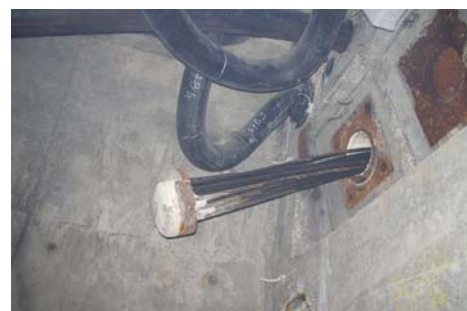
Expulsion de l'extrémité d'un câble 19T15 lors d'un démontage
