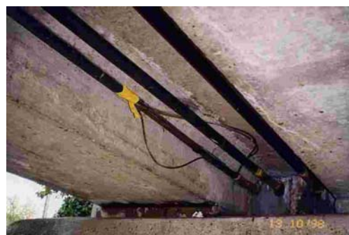
Rupture de torons non protégés par du coulis
