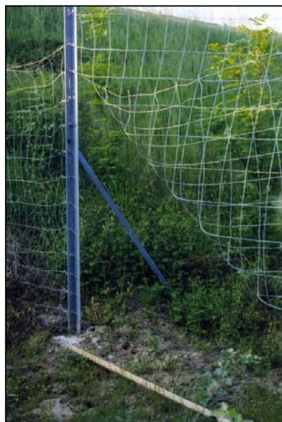
Photo 10 : Autoroute A5, dégâts sur clôture Source : J. Carsignol - Cete de l'Est
