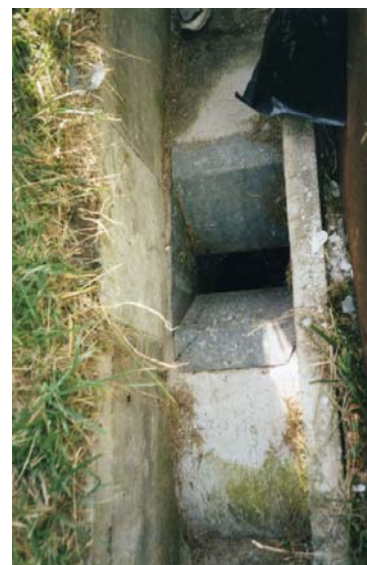
Photo 56 : Autoroute A41 (ATMB), fosse de capture dans la vallée blanche Source : J. Carsignol – Cete de l'Est
