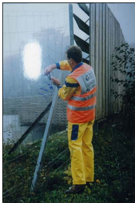
Photo 11 : Autoroute A5 (APRR), entretien des clôtures sur l'A 5 Source : J. Carsignol - Cete de l'Est
