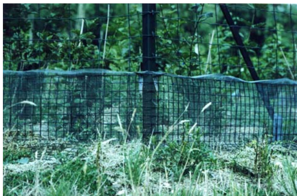
Photo 9 : Autoroute A16 (SANEF), système de rabat en partie haute pour empêcher l'escalade de la petite faune Source : J. Carsignol - Cete de l'Est
