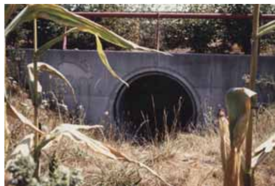
Photo 41 : Autoroute A35 (Haut Rhin), passage petite faune non spécialisé Source : J. Carsignol – Cete de l'Est
