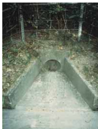
Photo 42 : dispositif d'entrée d'un passage petite faune avec un "entonnoir" maçonné qui facilite l'accessibilité de la faune au passage. Source : J. Carsignol – Cete de l'Est
