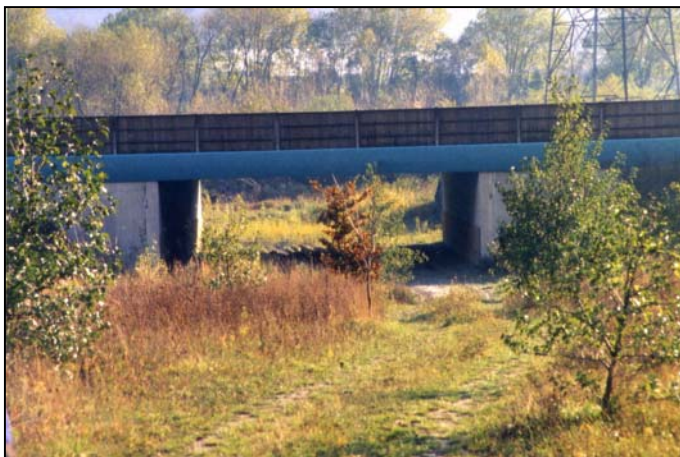
Photo 27 : Autoroute A43 (SFTRF), passage spécifique inférieur dans la vallée de la Maurienne Source : J. Carsignol – Cete de l'Est
