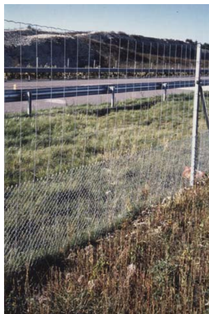
Photo 6 : Autoroute A85 (Cofiroute), clôture grande faune soudée à maille progressive Source : J. Carsignol - Cete de l'Est
