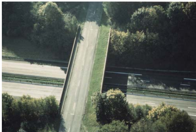
Photo 22 : RD 8 (Haut Rhin), surlargueur enherbée sur une route départementale très circulée (RD8) en Alsace non utilisée par la faune. Source : Recensement national des passages pour la grande faune : inventaire régions Champagne-Ardennes, Alsace-Lorraine (1991). J. Carsignol – Cete de l'Est [4]
