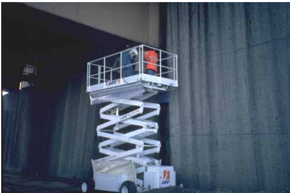
Inspection des appuis sur culée du pont Mathilde, à Rouen, à l'aide d'une nacelle de visite. Source : Fragnet M.
