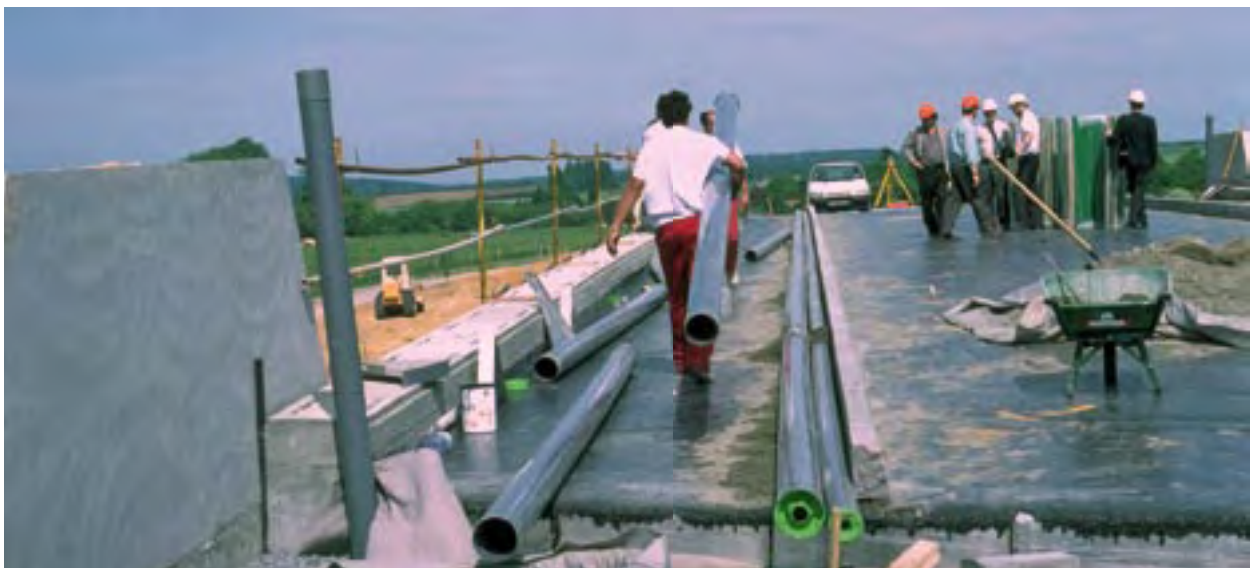
Figure 1 : Exemple de caniveau sous trottoir en rase campagne avec des réservations en attente pour les concessionnaires ou les canalisations destinées au gestionnaire.
