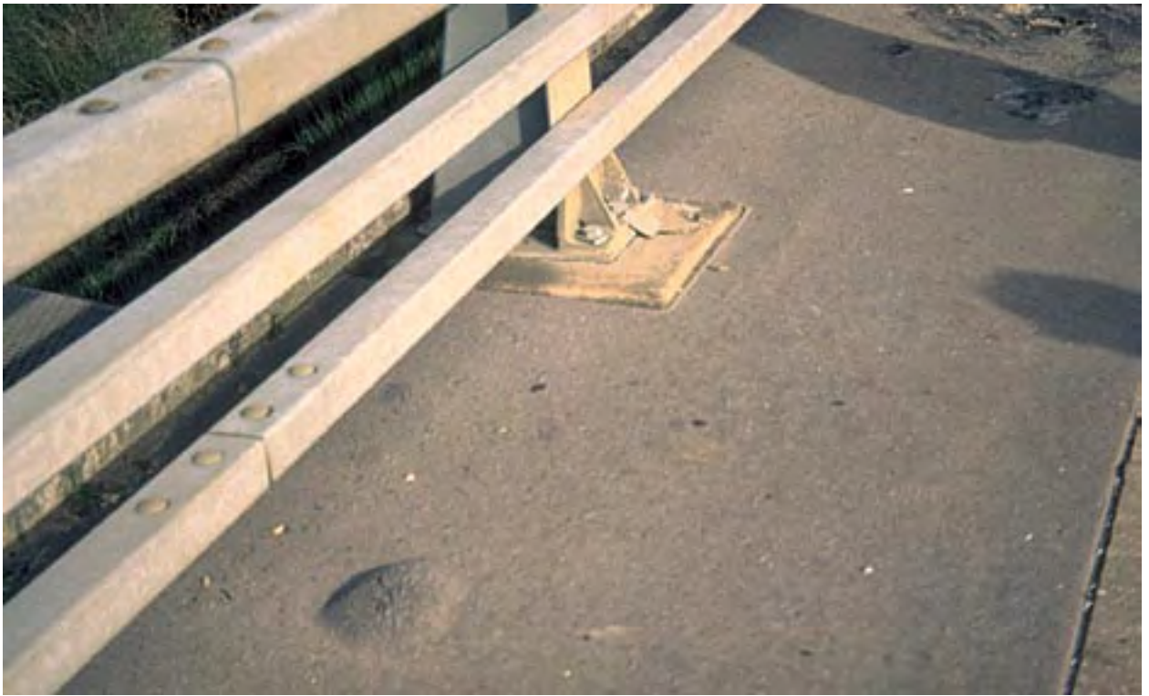
Figure 16 : Présence de gonfles sur trottoir en asphalte.
