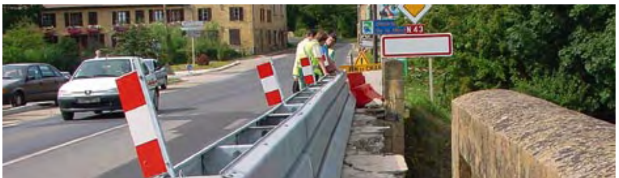
Figure 15 : Conséquences d'un défaut d'étanchéité combiné avec un assainissement mal conçu : le trottoir était au niveau du fil d'eau, et d'une structure insuffisamment ferrillée.
