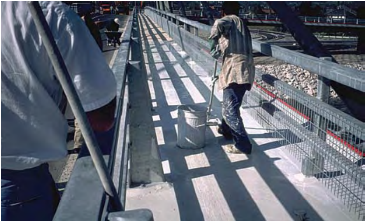
Figure 17 : Mise en œuvre d'un film mince adhérent au support sur un trottoir à circulation de piétons.
