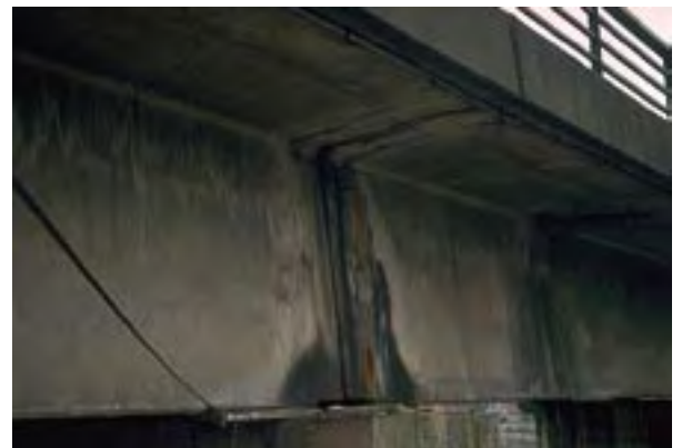
Figure 20 : Conséquences d'un défaut d'étanchéité du joint au droit du trottoir.
