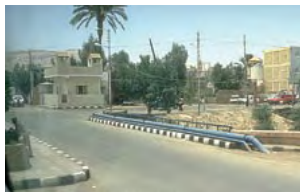
Figure 3 : Il est souhaitable que les canalisations soient dans le trottoir. Une telle disposition pose le problème de la sécurité des piétons, des automobilistes et au choc des canalisations, voire de vandalisme. (photo J.L. Michotey)
