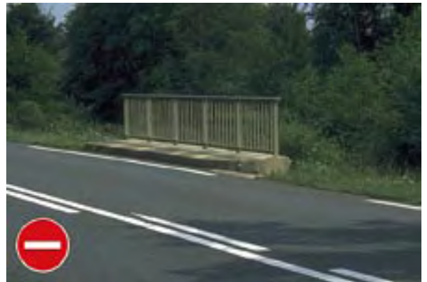
Figure 18 : Exemple d'aménagement pouvant présenter un danger pour la circulation automobile et un risque d'affouillement au ras de la culée. Voir l'aménagement de la figure 16.c du guide « Assainissement des ponts route » (repris au § 7.2 ci-dessus).
