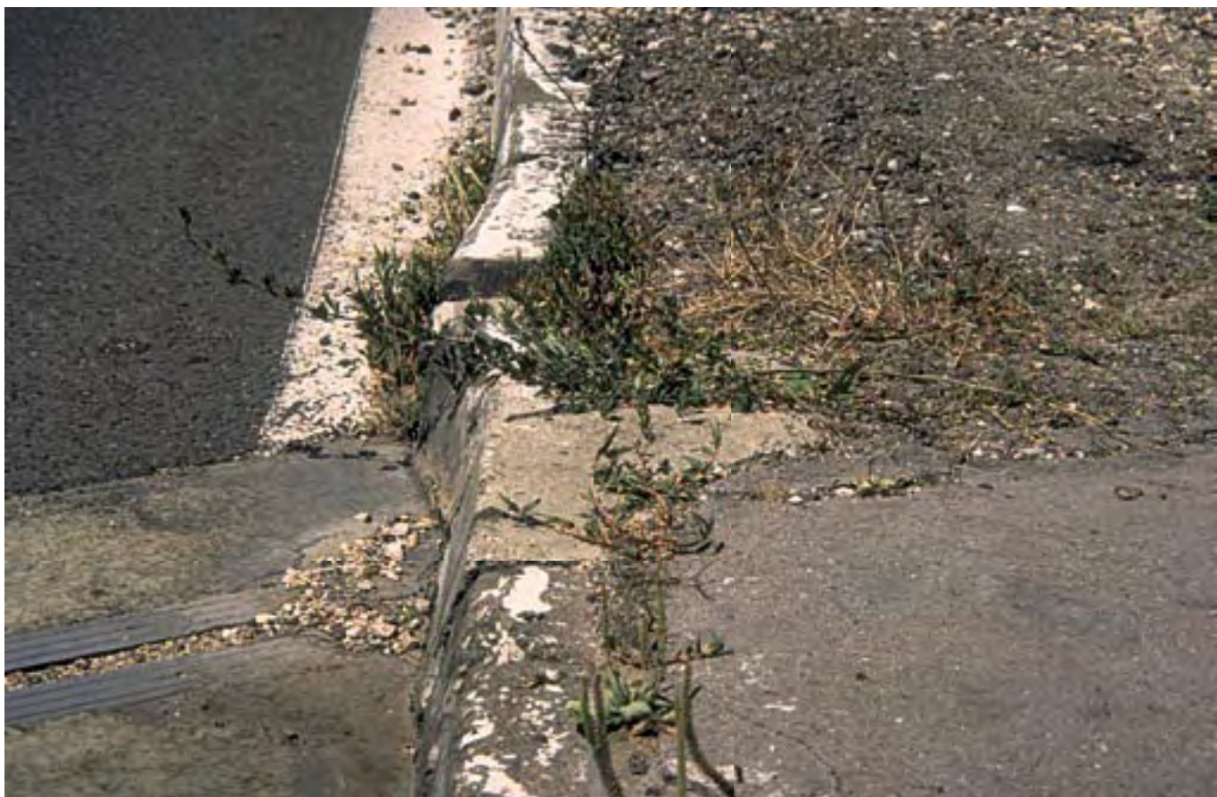
Figure 33 : Défaut d'entretien manifeste, pas de joint de trottoir, pas de joint dans la bordure de trottoir conduisant à un flambement des bordures, défaut du revêtement, etc.
