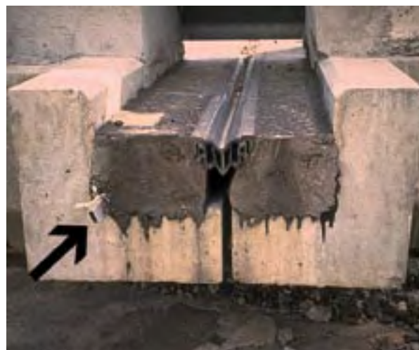
Figure 21 b) : Illustration de la disposition prolongeant le joint au travers de la longrine support de barrière. A noter la sortie du drain (Cf. flèche).
