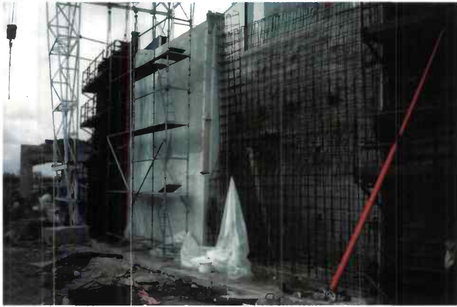
Figure 3.3 RÉALISATION D'UN MUR EN BÉTON ARMÉ À L'ABRI D'UNE PAROI CLOUÉE PROVISOIRE
