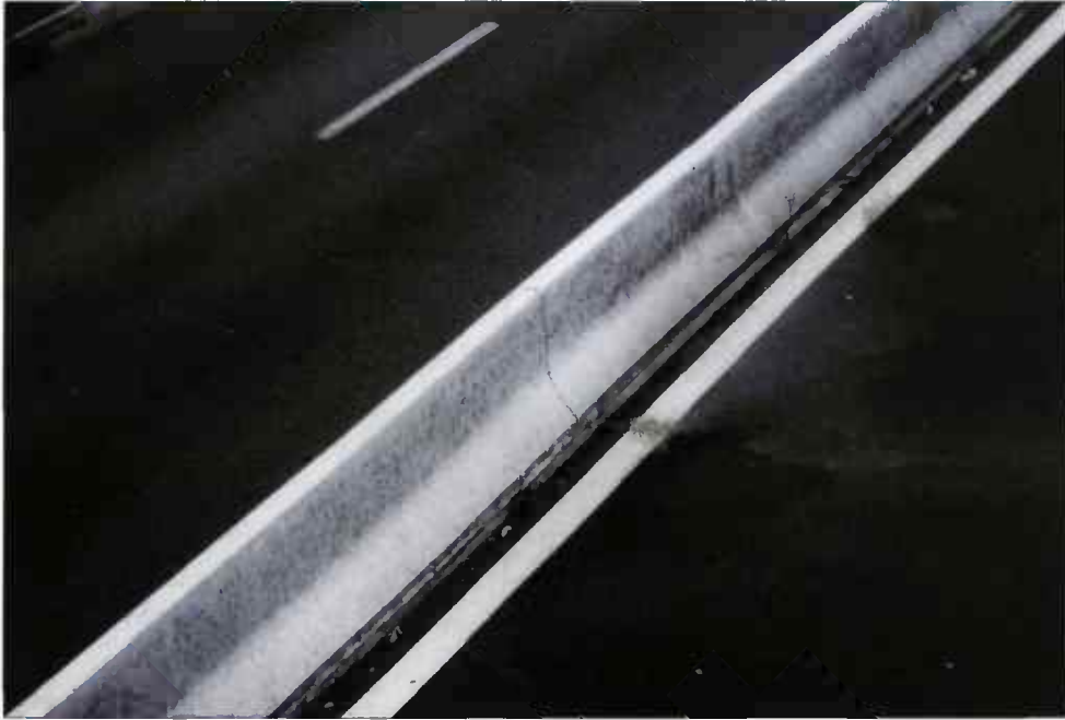
Figure 6.10 DÉFAUT D'ÉTANCHÉITÉ D'UN RADIER
