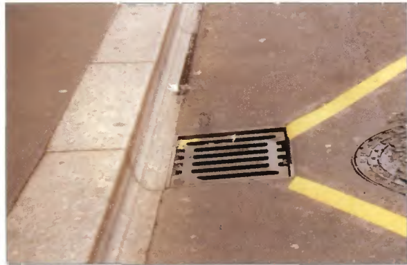
Exemple d'avaloir passé devant un point d'arrêt et enfoncé à cause du passage répété des bus, Strasbourg, arrêt Hamme de Fer (source : IDF Conseil)
