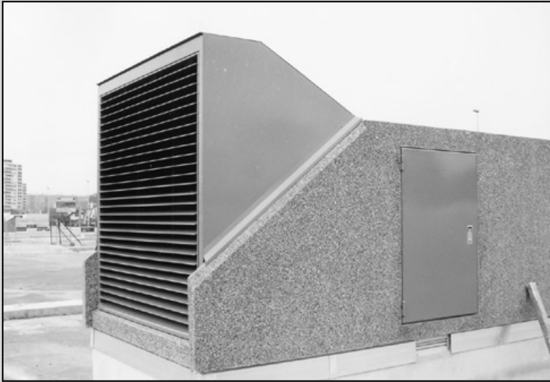
Édicule de désenfumage sur tranchée couverte
