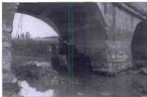
Effondrement de la pile du pont de Chateouneuf-sur-Charente, à la suite d'une fouille creusée en périphérie lors de travaux
