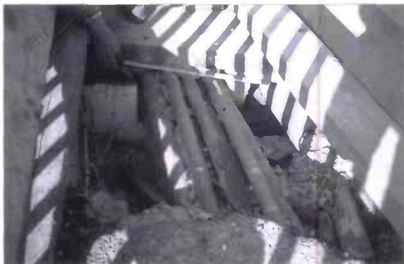
Présence de canalisations sous trottoir.
